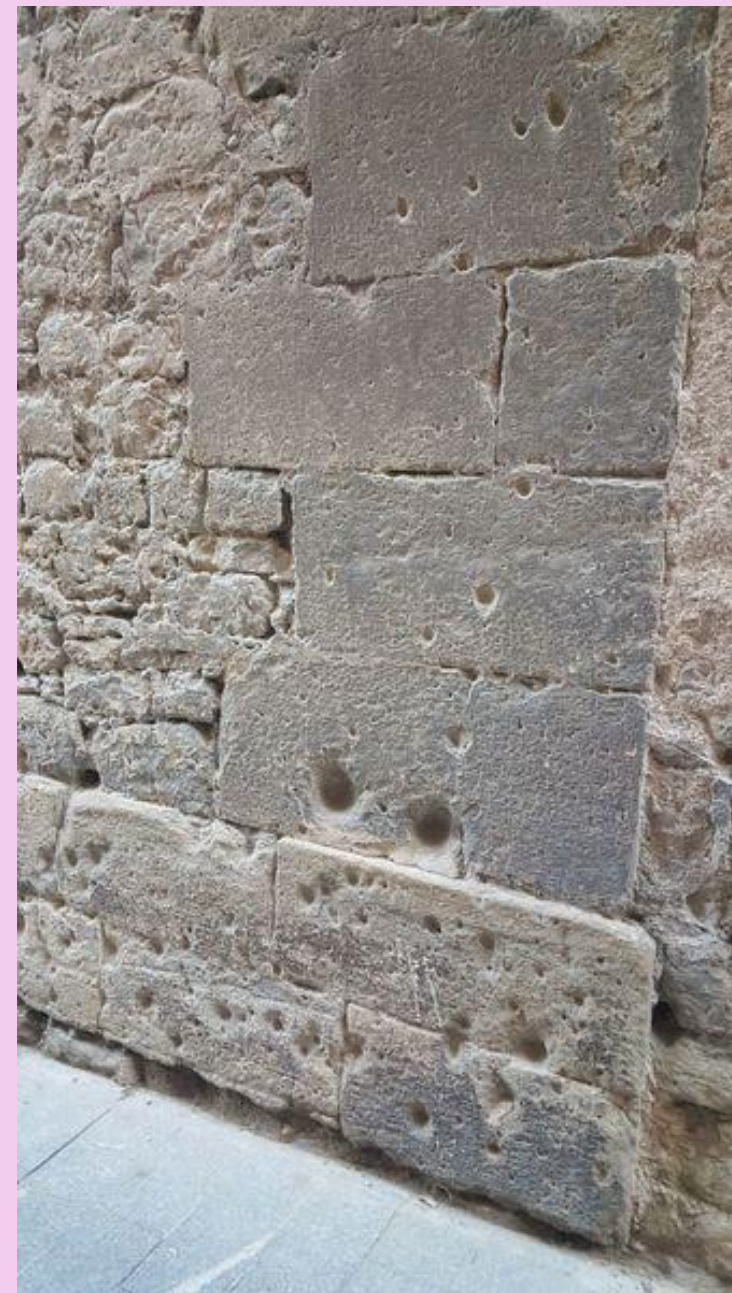
Impactes de metralla a la façana del Museu que dona al carrer de Viladordis.
