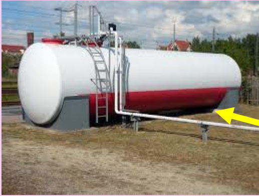
Dipòsits de combustible
